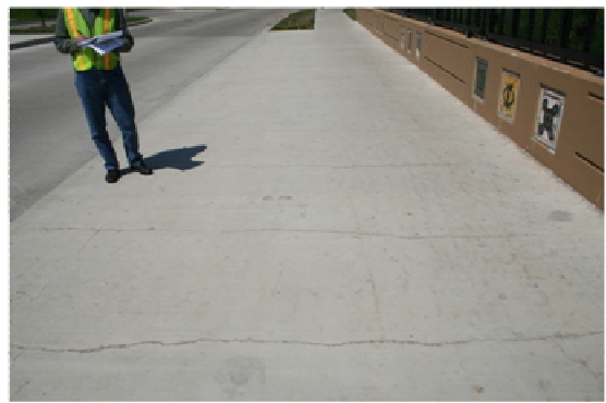
(d) B-40-692 Cracks in Sidewalk
